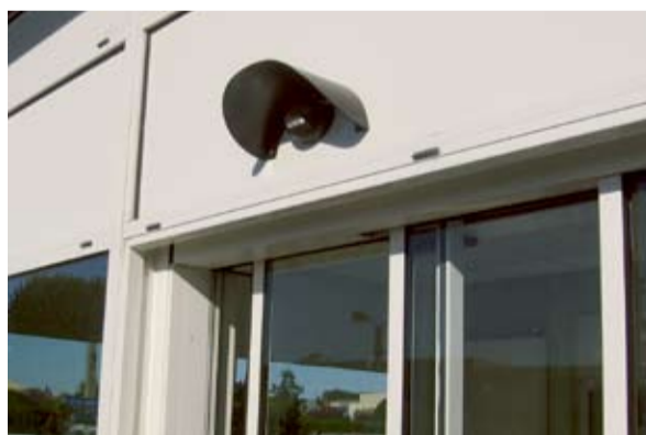
À l'entrée de certaines gares, a été installé un guidage audio de positionnement et de direction pour les mal entendants.
